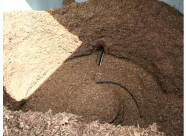
Intérieur du silo de la chaufferie bois
